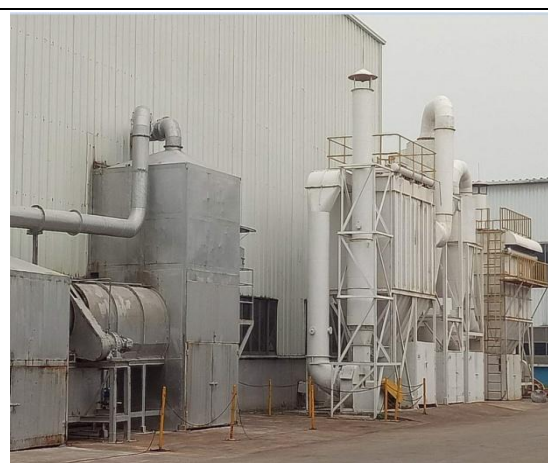
图 2-9 铸造车间废气处理设施
